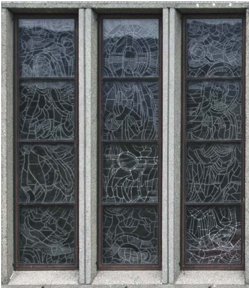
will Restauriertes Fenster mit sichtbar erneuerten Lötstellen in Segmenten a1 und b2
